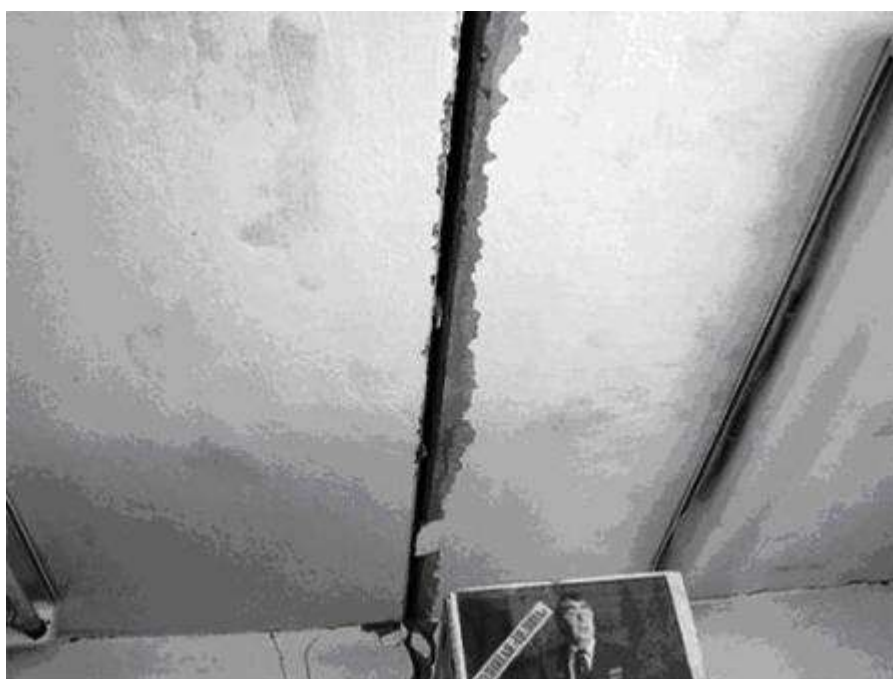
Рисунок 4 - Раскрытие швов между плитами покрытия
