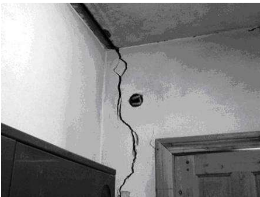
Рисунок 2 - Трещины в стене
