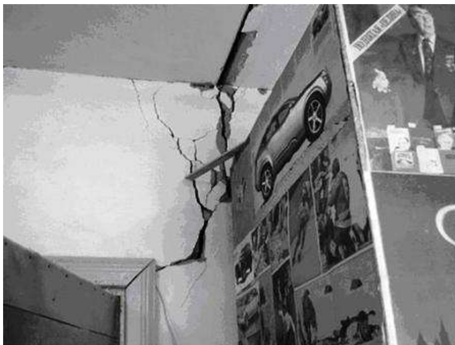
Рисунок 3 - Трещины в стене
