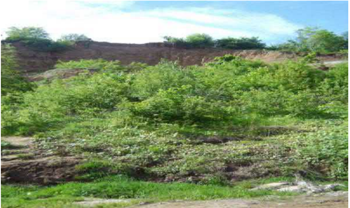
Рис. 1. Общий вид оползневого склона (г. Чебоксары, район Заовражье)
